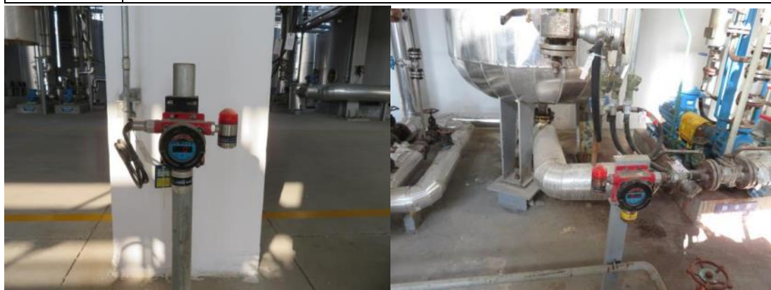
有害气体泄漏报警仪可燃气体报警仪现场照片
